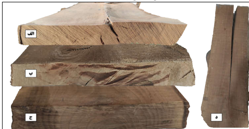
شکل ۸- ترک مقطعی در اسلب‌های دارای پهنای زیاد خشک‌شده با برنامه اول (الف) و (د)، برنامه دوم (ب) و برنامه سوم (ج).
